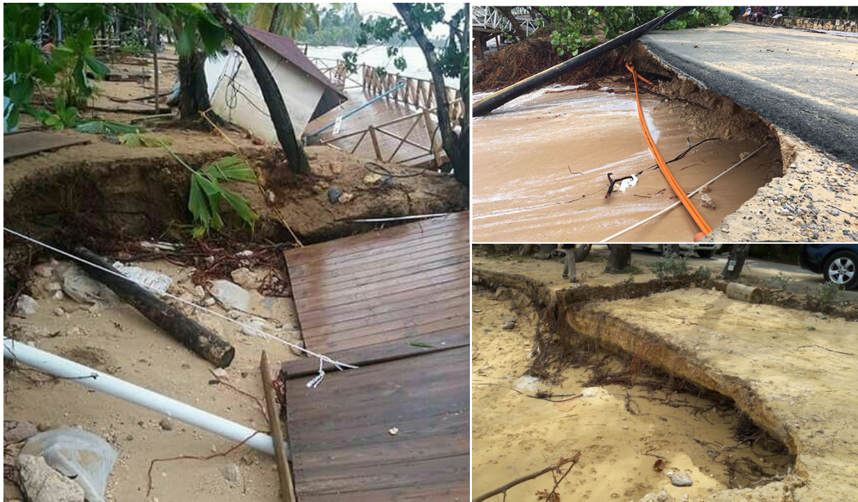
Foto 2. Daños a la zona costera de Las Terrenas al paso de los huracanes Irma y María. Destrucción de infraestructuras y escarpes de erosión en la playa. Fuente: Fotos de los autores de septiembre de 2017.
