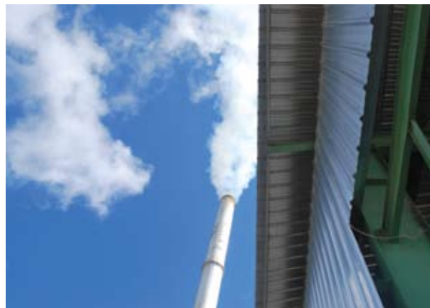
Chimenea de caldera para combustión de biomasa en Punta Cana.
