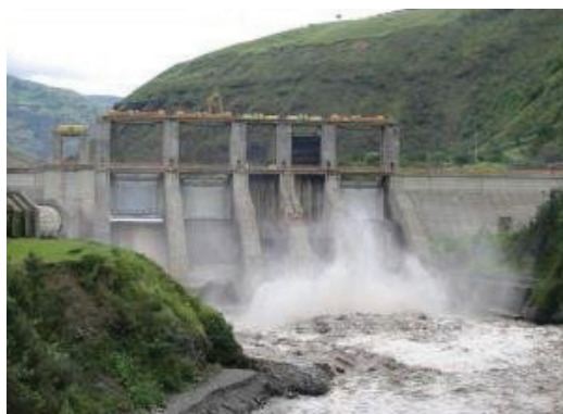
Figura 7: Se está construyendo una mini hidroeléctrica comercial en la comunidad Paso Bajito en Jarabacoa, la cual tendrá un costo aproximado de US$10 millones y generará cuatro megavatios al sistema eléctrico interconectado.
