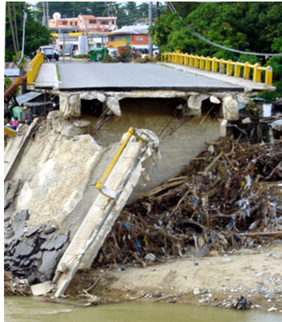
Foto 11. Daño en puente por efecto de las tormentas Noel y Olga en la provincia San Cristóbal. Juan Carlos Orrego, 2007.
