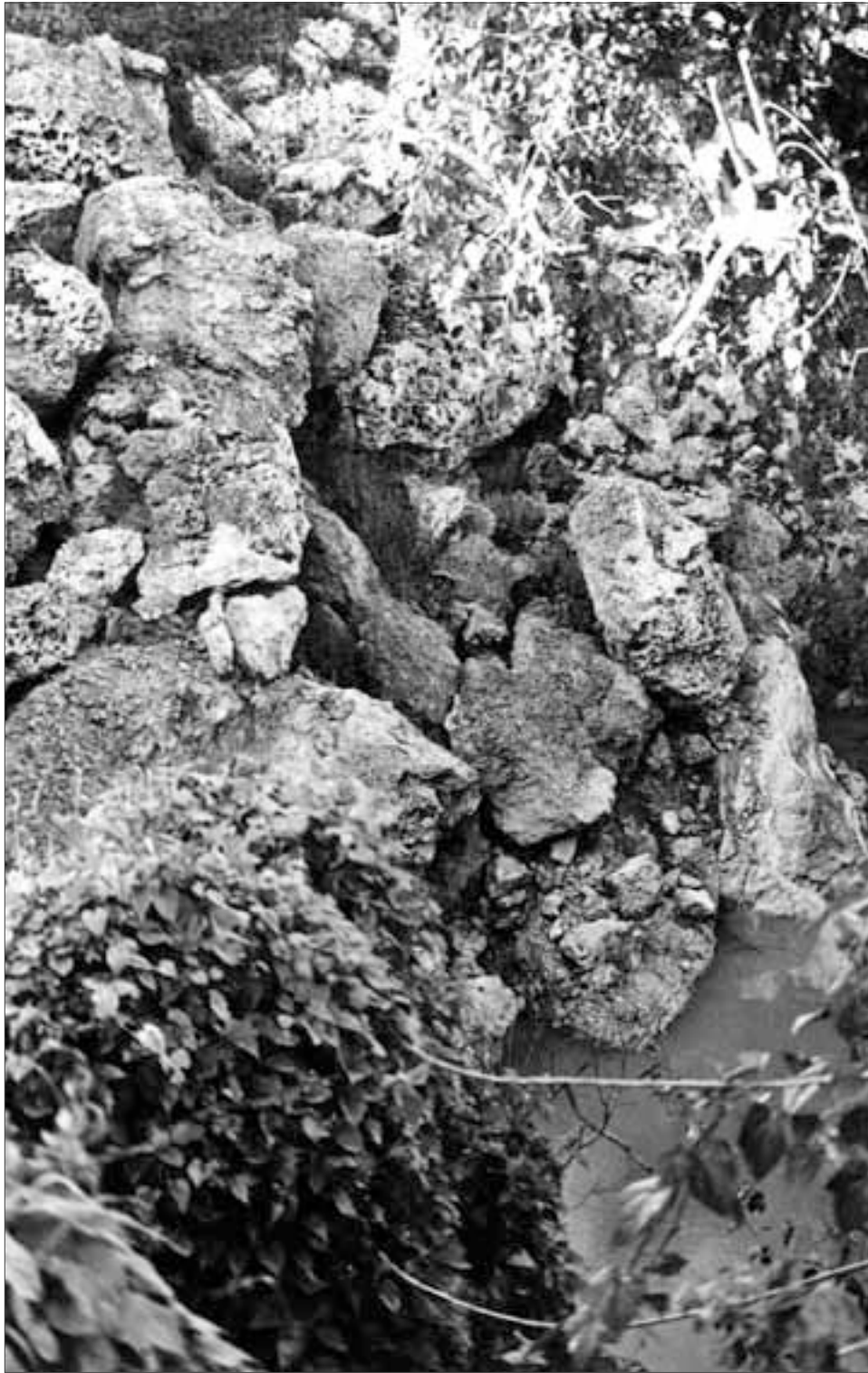
Pared de roca caliza en el sumidero del río Brujuelas. Se observan fragmentos de los frecuentes derrumbes que se producen aquí.
