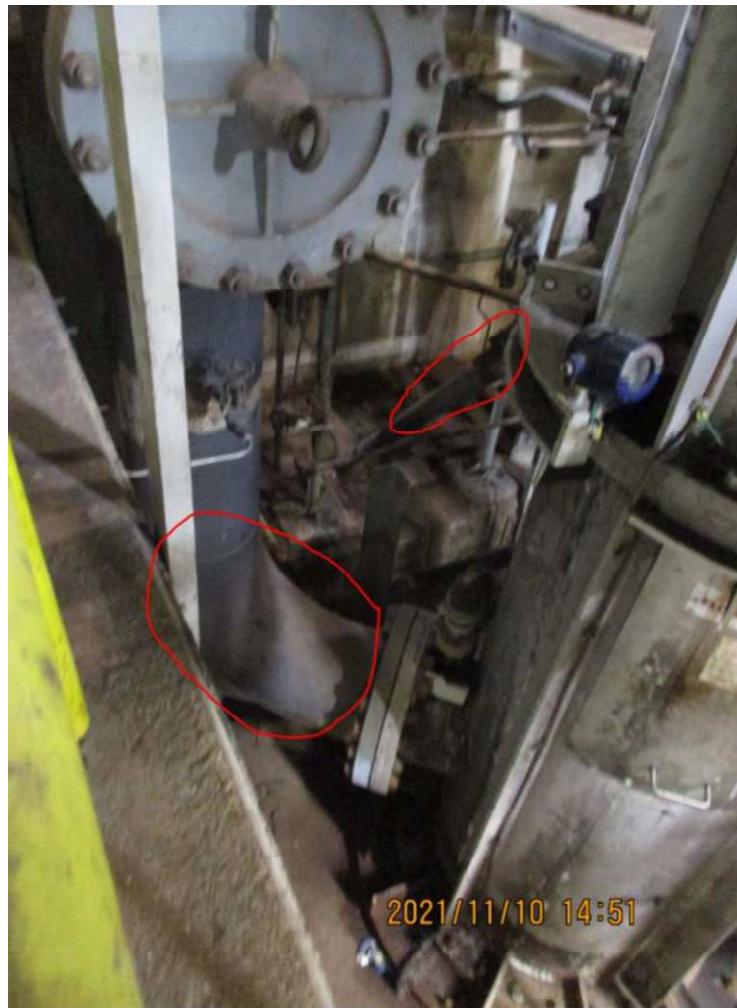
Figura 3-31 — Descarga de la Bomba de Condensado y Refuerzo
