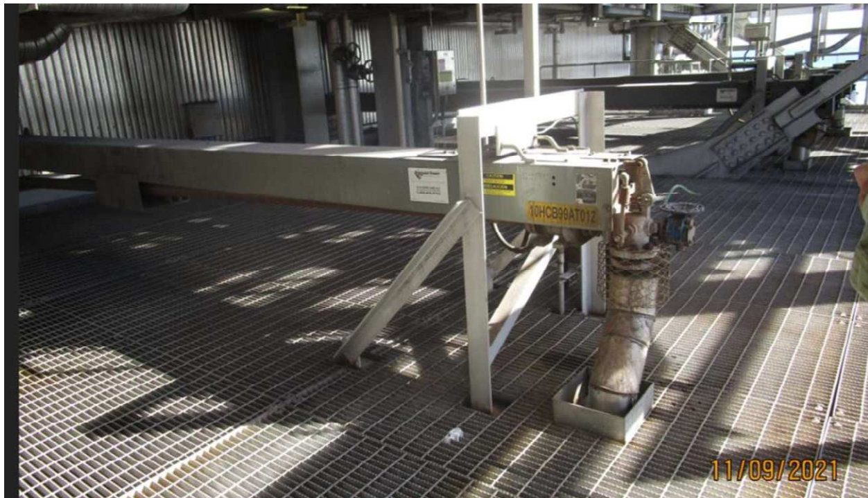
Figura 3-25 — Soplador de Hollín de la Caldera
