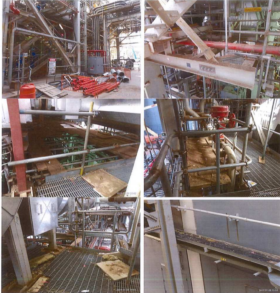
Figure 3-9 — Ejemplos de escombros durante la construcción y riesgos para la seguridad
