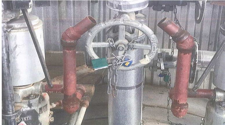
Figura 3-7 — Venteo de vapor peligroso
