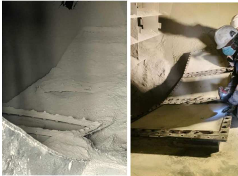
Figura 3-36 — Pantallas de aire de fluidificación y caída de partículas en el codo de entrada del CFB
