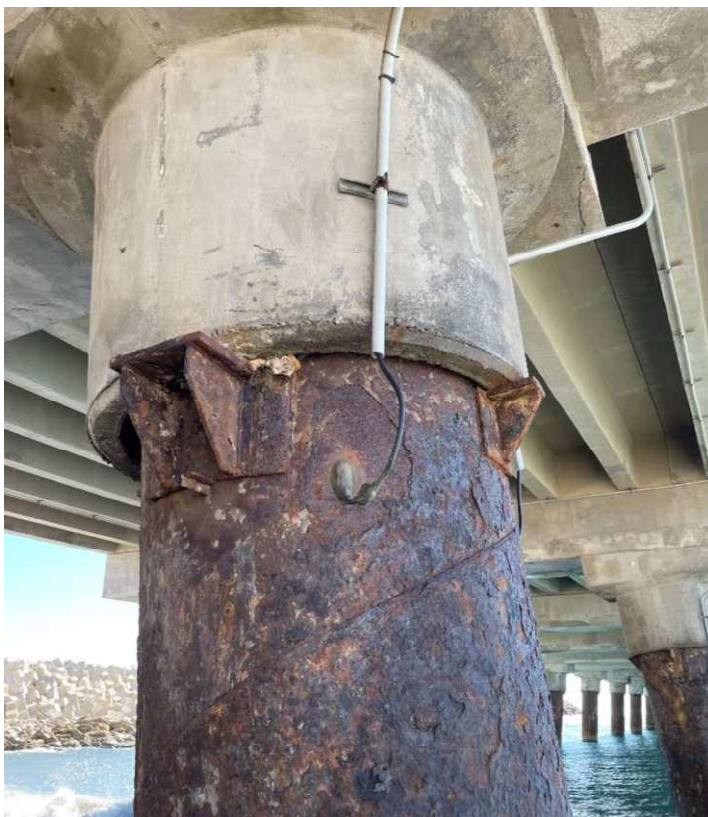
Figura 3-5 — Ejemplo de Corrosión de los Pilotes del Muelle
