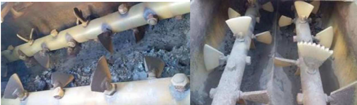
Figura 3-26 — Interior del Mezclador de Cenizas de Fondo
