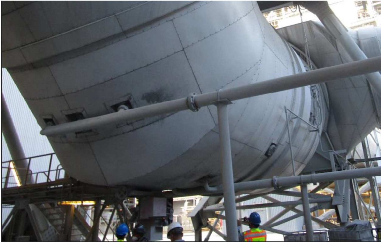
Figura 3-35 — Codo de Entrada de CFB
