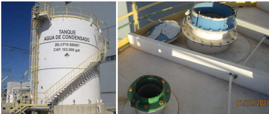
Figura 3-28 — Tanque de Almacenamiento de Condensado
