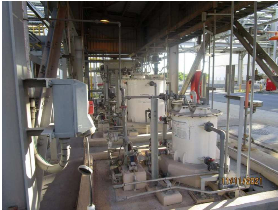
Figura 3-40 — Sistemas de Dosificación de Químicos para Agua Potable
