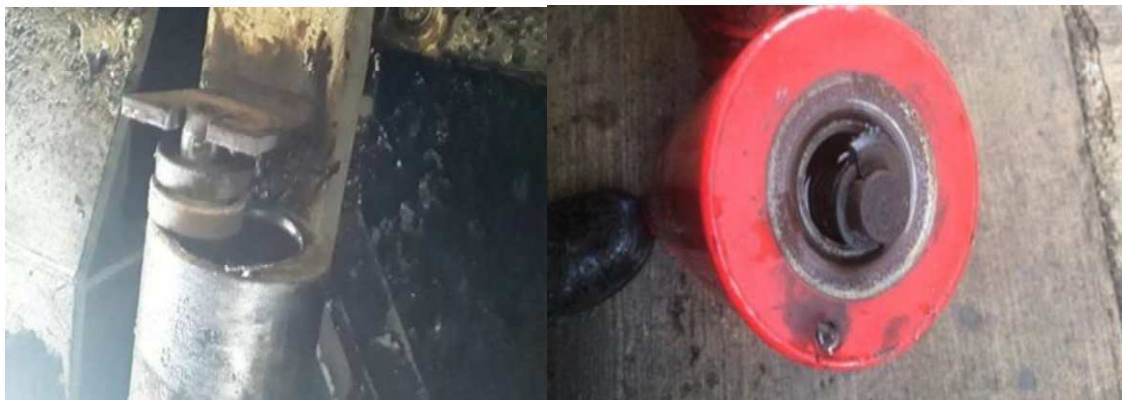
Figura 3-3 — Falla de los Cojinetes de Rodillos en el Transporte Tubular
