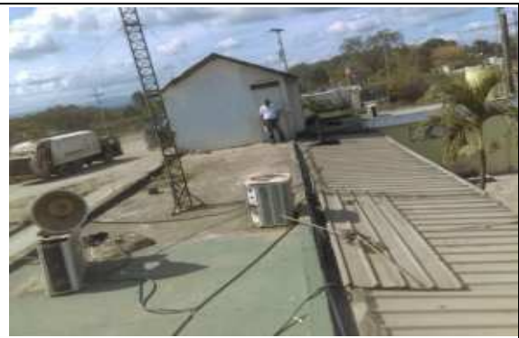
Foto 14: Vista general del techo Edificio Oficinas Comisión Administrativa, Área de peso y Encargado de Transportación. Se observa al fondo, caseta de vigilancia fuera de operación actualmente.
