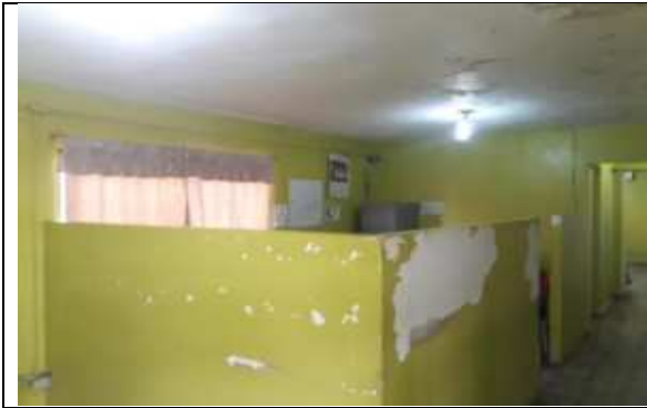
Foto 15: Vista general de las oficinas de la Asistente Administrativa y secretaria, en antesala de oficina de directores Administrativo y Operaciones. Se observa deterioro de pintura.
