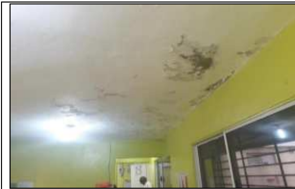
Foto 13: Vista cercana del techo del área de oficinas asistente administrativa y secretaria, afectado por filtraciones.
