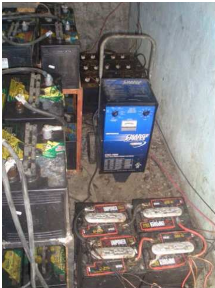
Figura 6 Cargador y bancos de baterías. Nótese los polos sulfatados (color azul) en las baterías de la izquierda.
