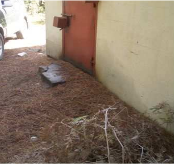
Figura 12 Contaminación oleosa crítica en la caseta de generación del mismo lugar (nótese el brillo del aceite sobre el escalón).
