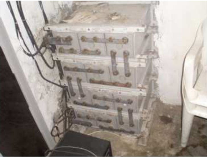
Figura 8 Vista interior de una caseta con algunas manchas aceitosas en el piso.
