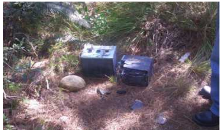
Figura 11 Dos baterías se encontraron semidestruidas, una sin partes de plomo en la parte posterior de una caseta de radiocomunicación.
