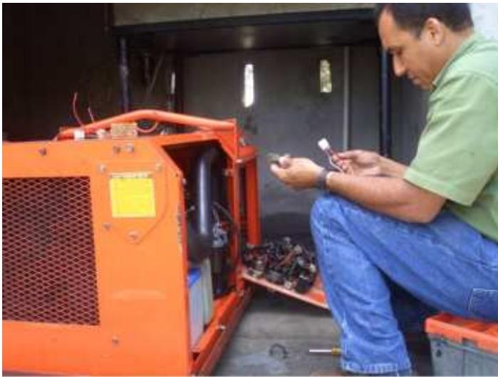
Figura 4 Proporcionando mantenimiento a un generador diesel.
