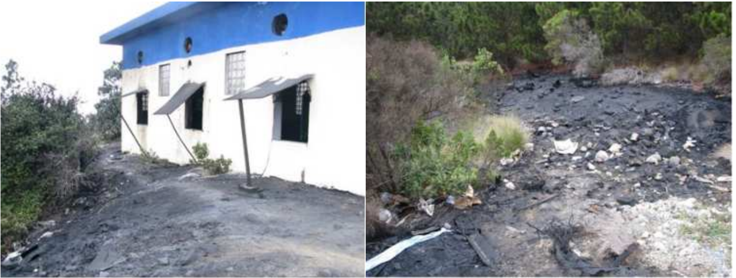
Figura 17 Planta de la CDEEE en Alto Bandera. Los derrames oleosos comienzan su efecto contiguo a la edificación de la Planta y mezclados con filtros de aceite y otros desperdicios, se extienden por más de 50 metros, ladera abajo, formando una especie de “capa asfáltica”.
