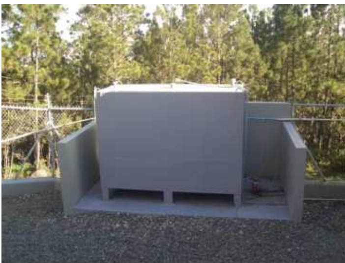
Figura 13 Tanque de combustible de Orange. Obsérvense solo tres paredes de contención en lugar de cuatro.
