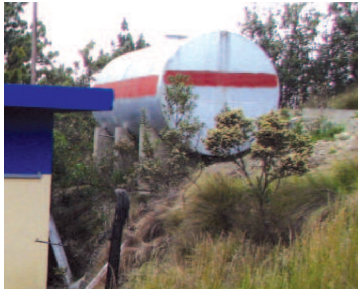
Figura 14 Tanque de combustibles sin muros de contención de derrames. Planta de la CDEEE en Alto Bandera.
