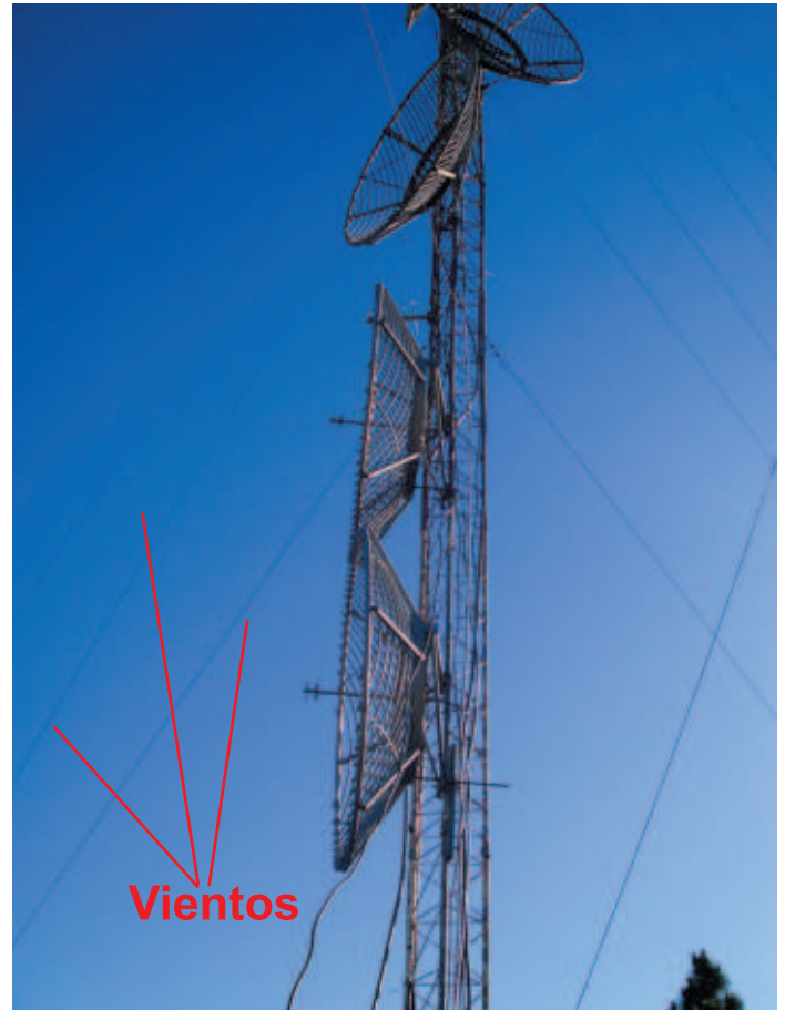
Figura 7: Fotografía de torre con vientos.
