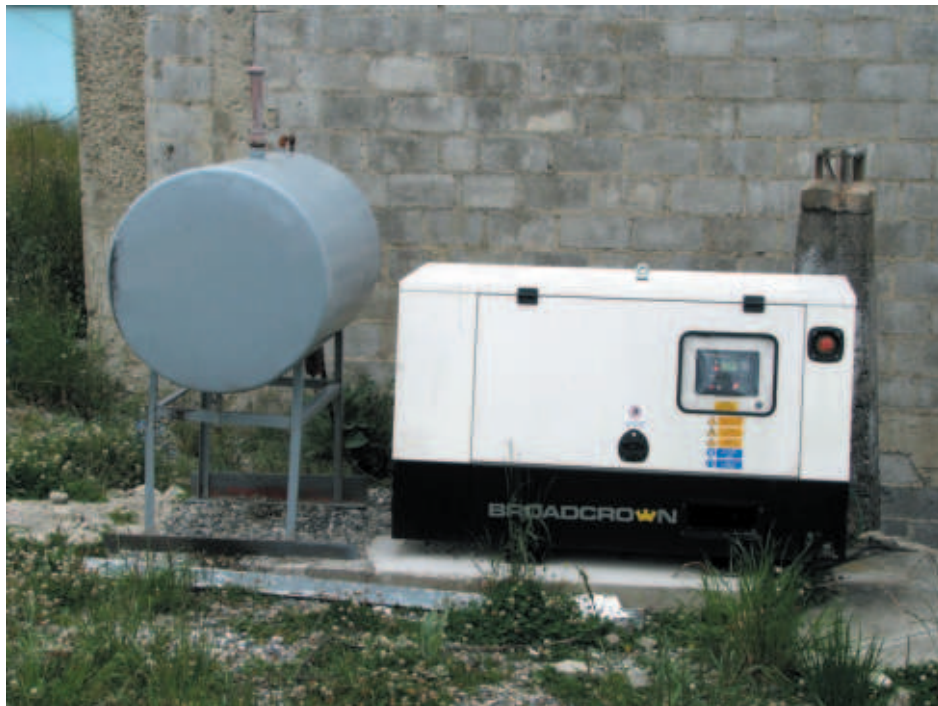
Figura 15. Generador de electricidad.
