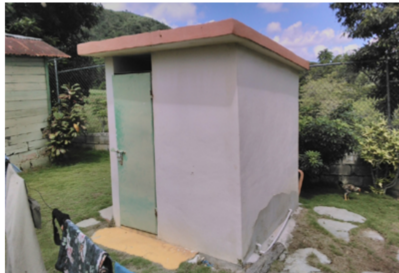
Ilustración 10: ejemplo de instalación mejorada fuera de la vivienda. Fuente: levantamiento de hogares de CORAASAN.
