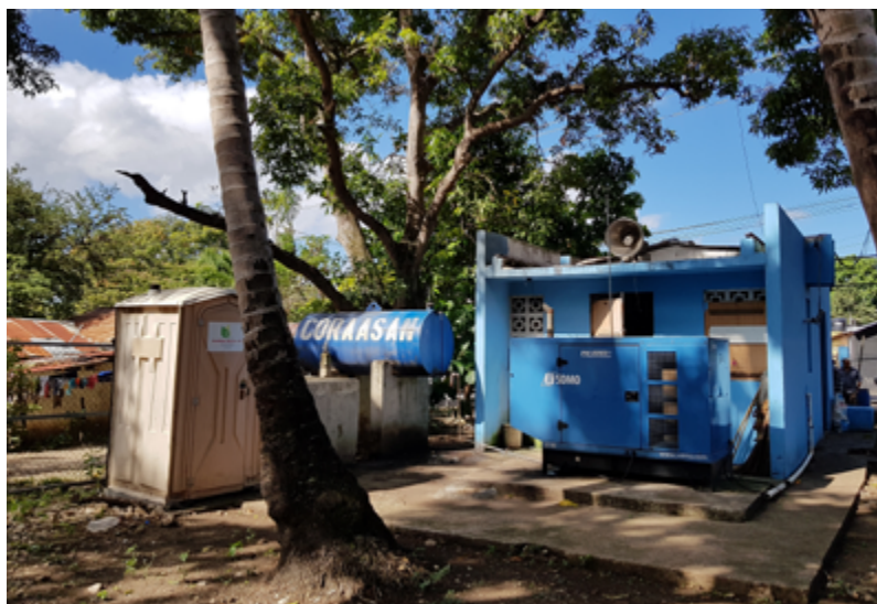
Ilustración 14: ejemplo de captación subterránea por bombeo eléctrico gestionado por CORAASAN, en Los Cocos, municipio de Santiago de los Caballeros. Fuente: elaboración propia.
