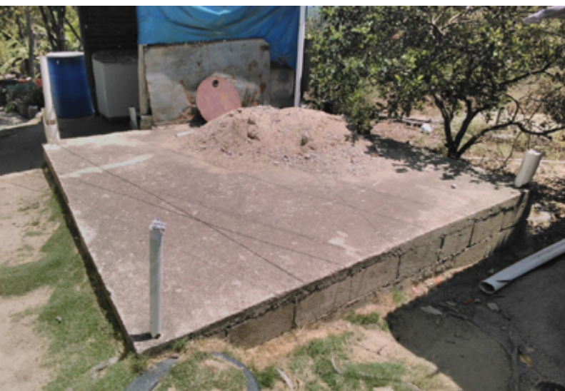
Ilustración 11: construcción de nueva instalación sobre una fosa. Fuente: levantamiento de hogares de CORAASAN.
