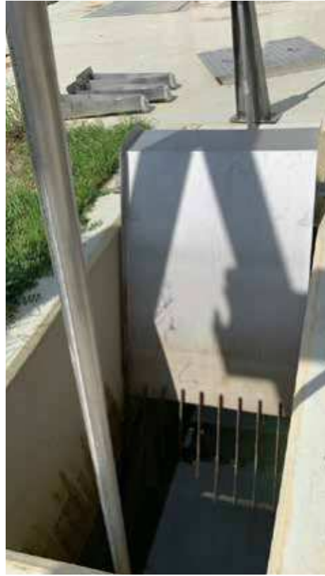
Pretratamiento: rejillas de desbaste.
