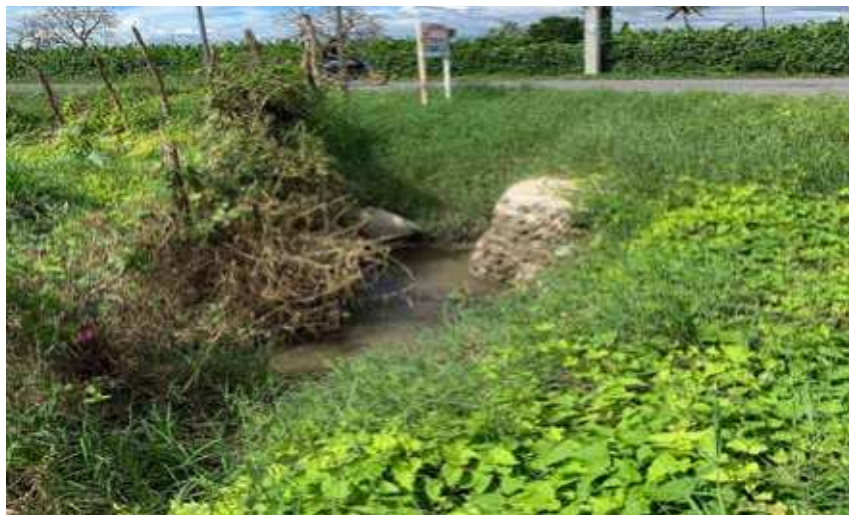
Entrada del agua residual a canal abierto: afluente.
