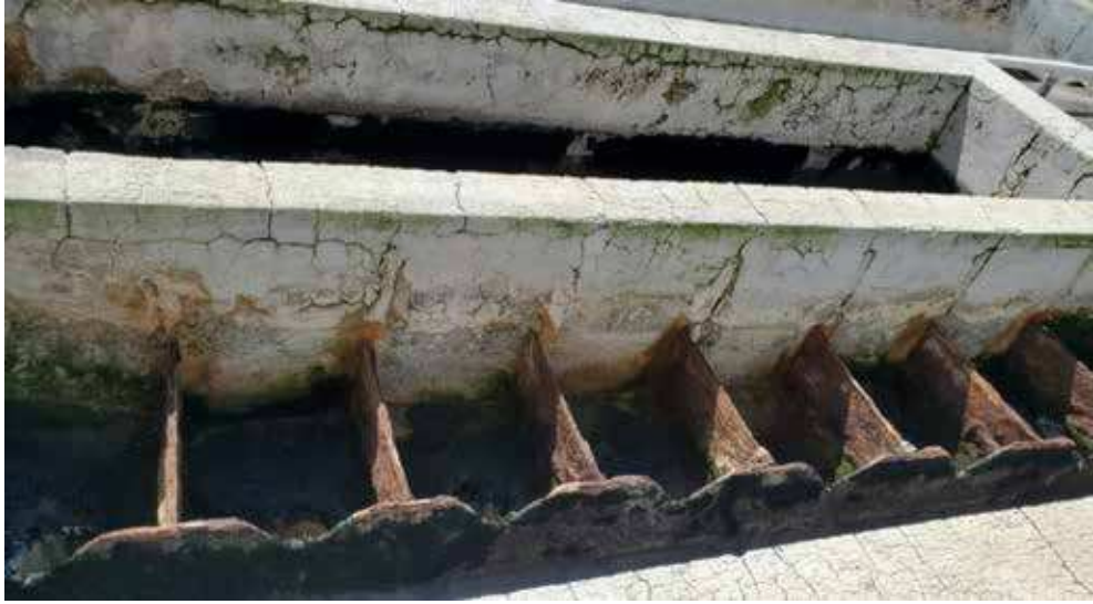
Lodos: total abandono.
