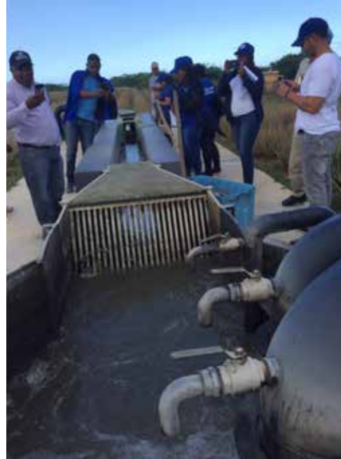
Pre-tratamiento: Rejillas de desbaste
