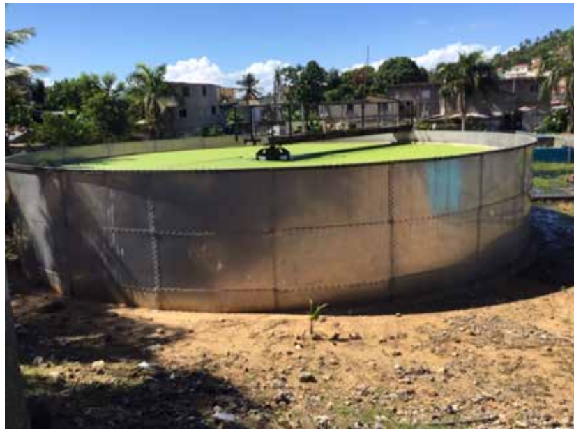
Sedimentador secundario: eutrofizado.
