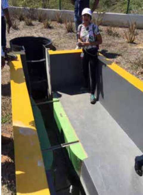
Medidor de flujo Parshall
