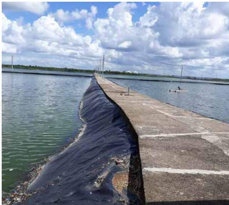
Laguna de Oxidación
