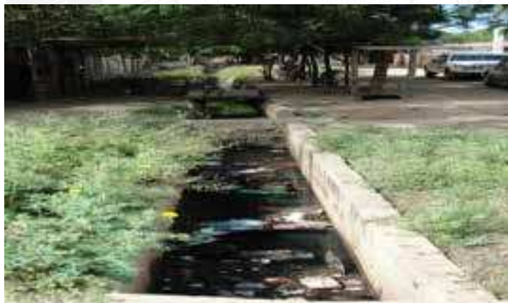
Canales de conducción de las aguas residuales de Los Barrancones
