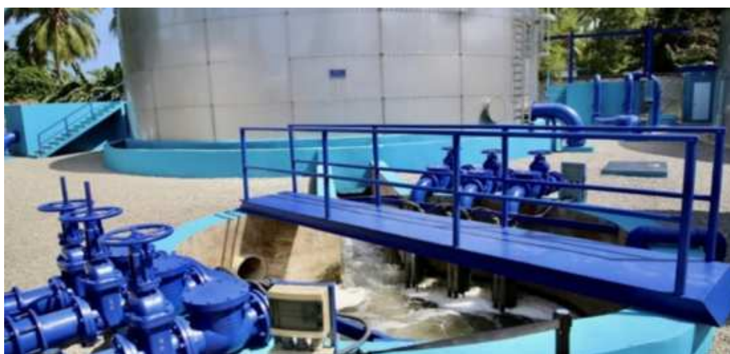
Vista parcial planta tratamiento aguas residuales de Las Terrenas .Fuente: www.ensegundos.do
