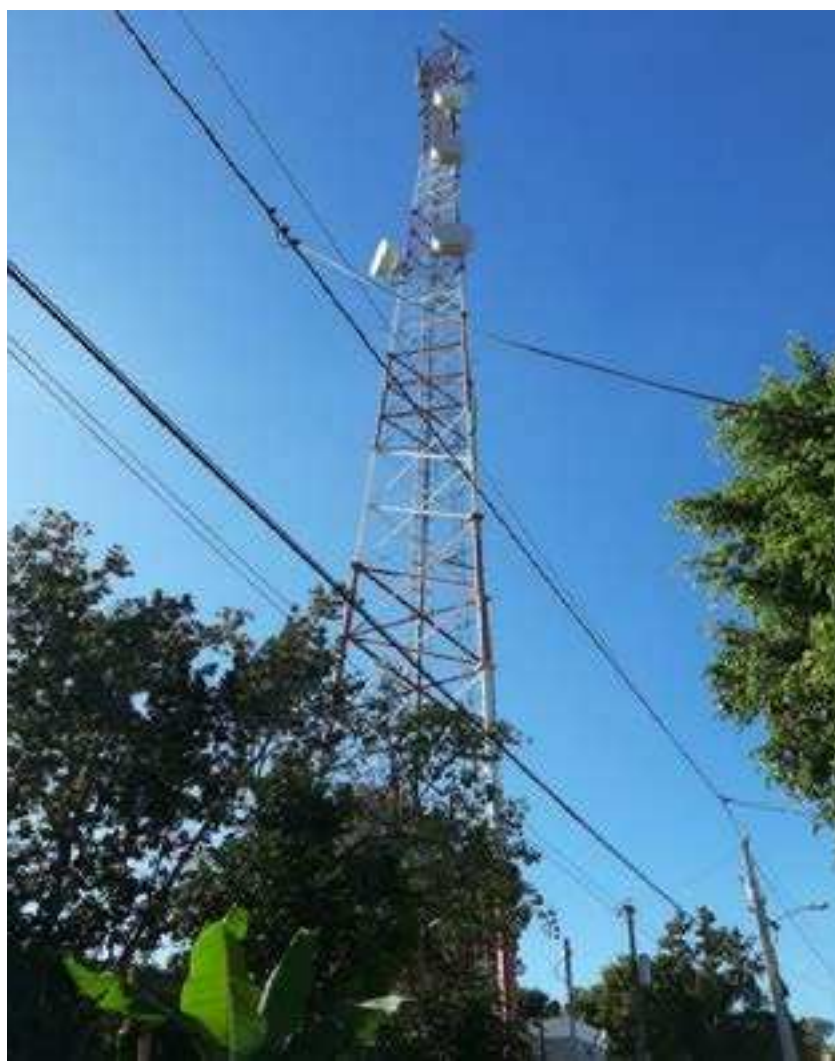
Antena de telecomunicaciones en Partido
