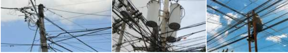
Foto 2 c5: Fotos estado del cableado urbano en el DN
