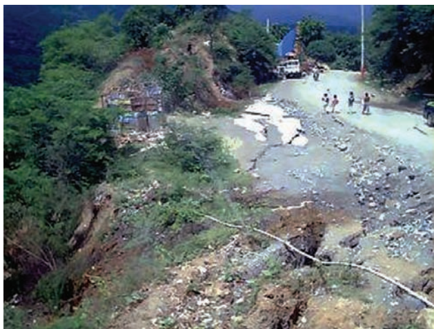
Foto 5. Deslizamiento Carretera de Ocoa.
