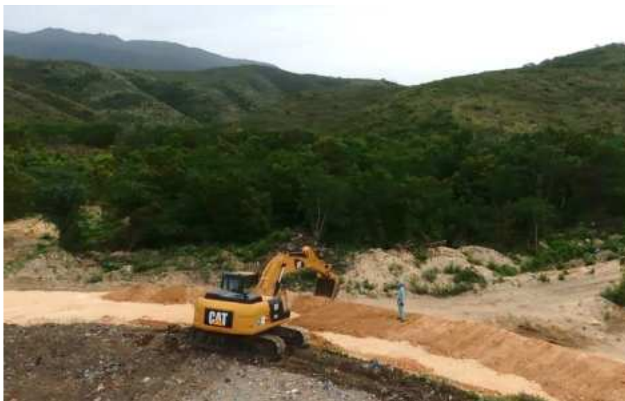
Fuente: Equipo de expertos de JICA, Rehabilitación Vertedero Azua, RD. 2017.- Foto 6. Instalación de Dique para un área de depósito de residuos
