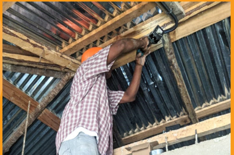
Paneles solares instalados y realización de la electrificación residencial por parte de la DERS del MEMRD.
