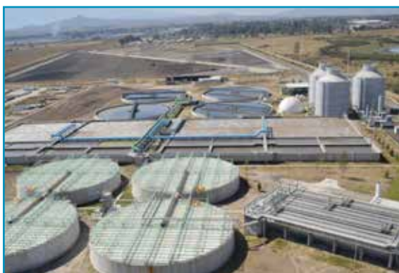
Planta de biogas El Ahogado, Jalisco.
