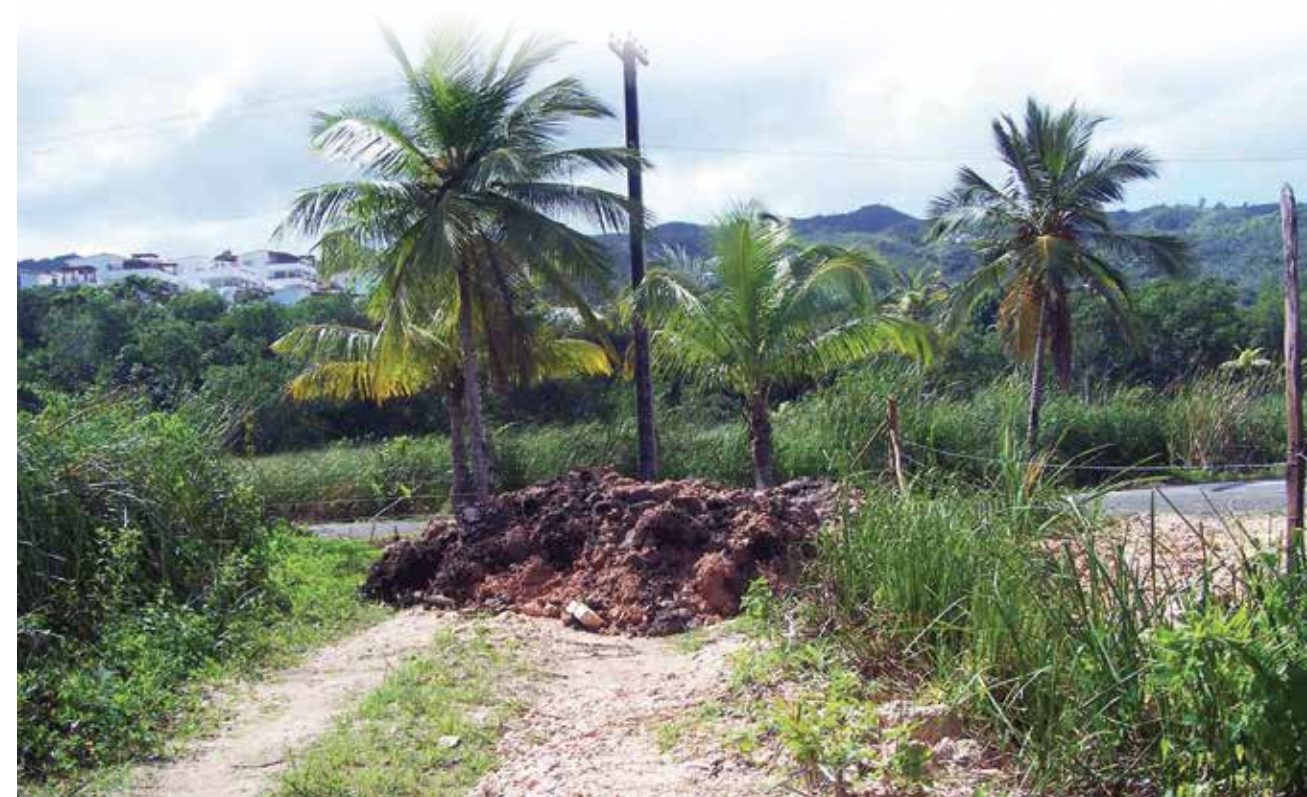
Relleno de humedal para la construcción de la vía Santo Domingo-Samaná. Juana Peña
