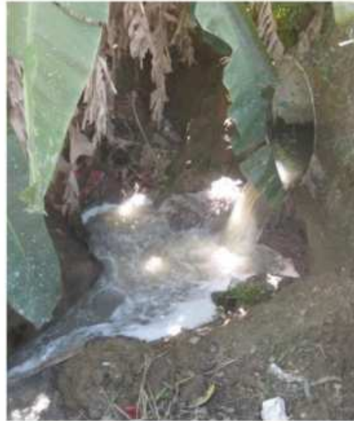
FIGURA 124. VERTIDO DIRECTO DE AGUAS RESIDUALES A LA CAÑADA PONTEZUELA
