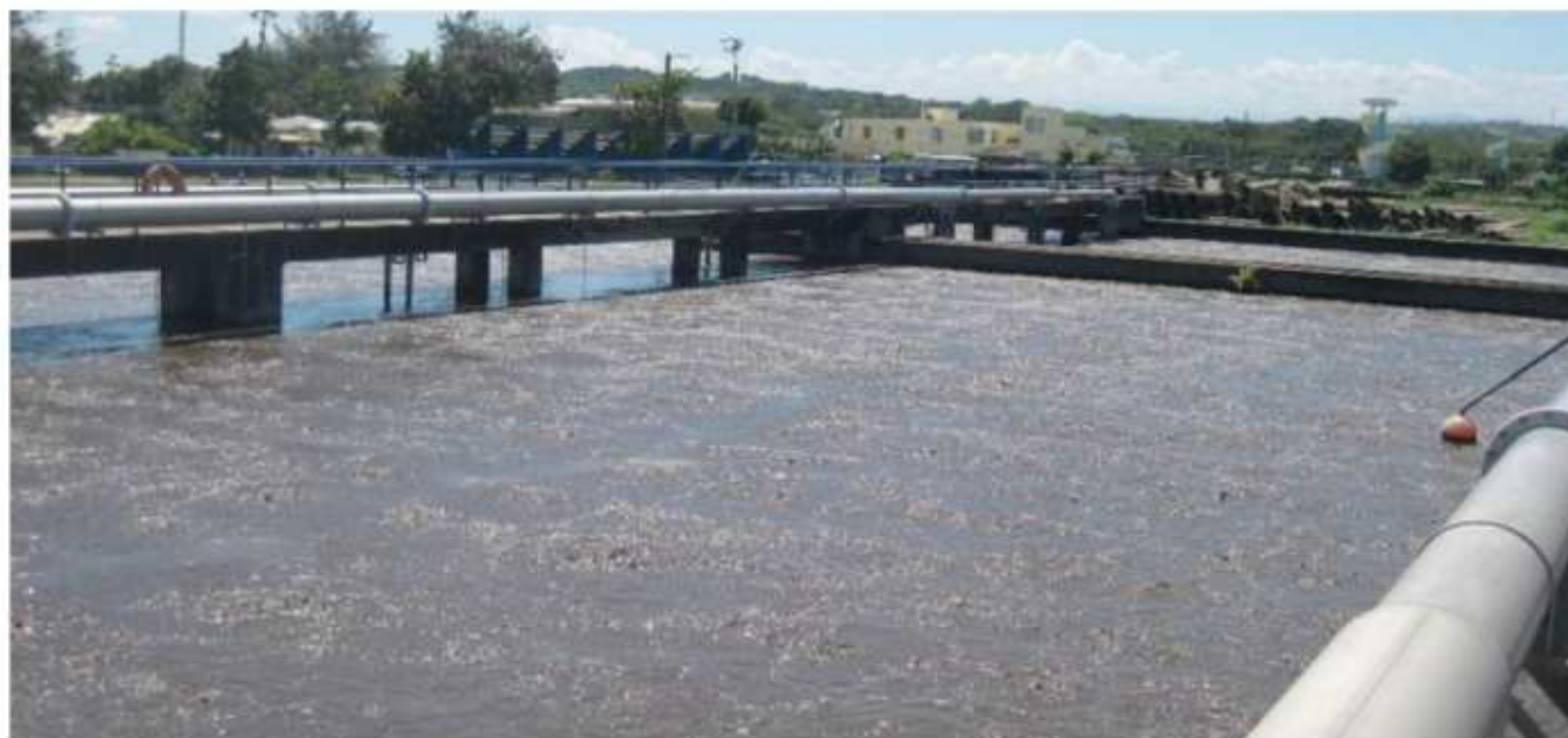
FIGURA 129. PTAR RAFEY, TRATAMIENTO SECUNDARIO DE LODOS ACTIVADOS
