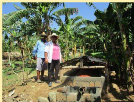
El establecimiento de un generador de biogás en la Cuenca del Cienfuego, Cuba
