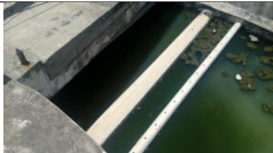
Foto 09: Déficit en el funcionamiento de distribuidores.
