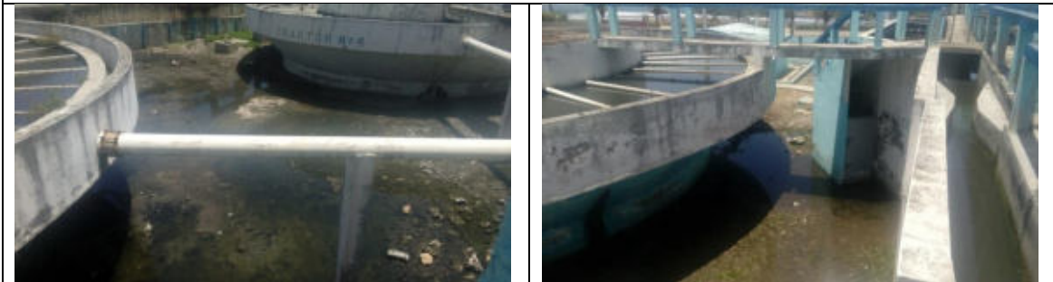
Fotos 03 y 04: Filtraciones en urbanización.
