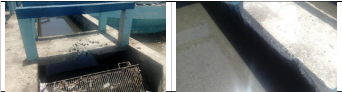
Fotos 01 y 02: Pérdida de resistencia en concreto.
