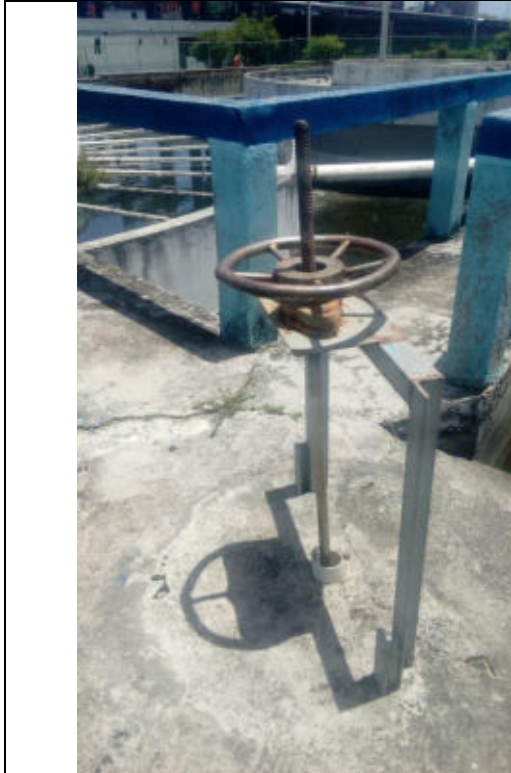
Foto 05: Desperfectos geométricos por deficiente instalación o sobrevenidos con posterioridad.
