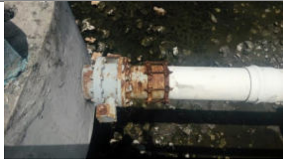
Foto 08: Oxidación de elementos metálicos.
