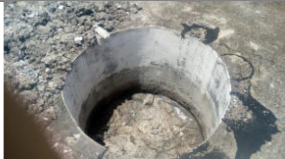
Foto 07: Obstrucciones en elementos de la planta.
