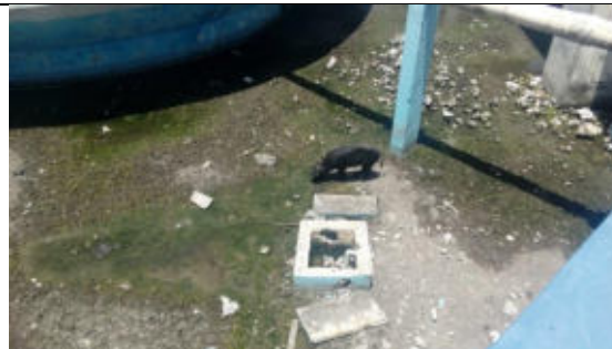
Foto 10: Desperfectos en urbanización e inundación de urbanización.
