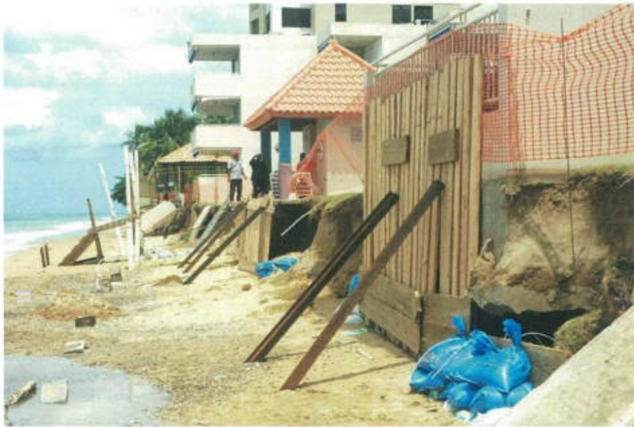
Septiembre de 2008 (un año después): La marejada arrasó con las escaleras, con las verjas y con la glorieta. Se demostró que los edificios fueron construidos muy cerca de la zona de actividad de la playa.
