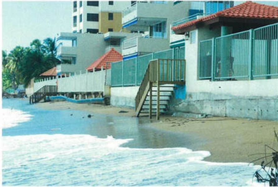
Septiembre de 2007: Estos condominios construidos en Playa Córcega, Rincón, Puerto Rico se encuentran muy cerca del mar. En un futuro, podrían colapsar.
