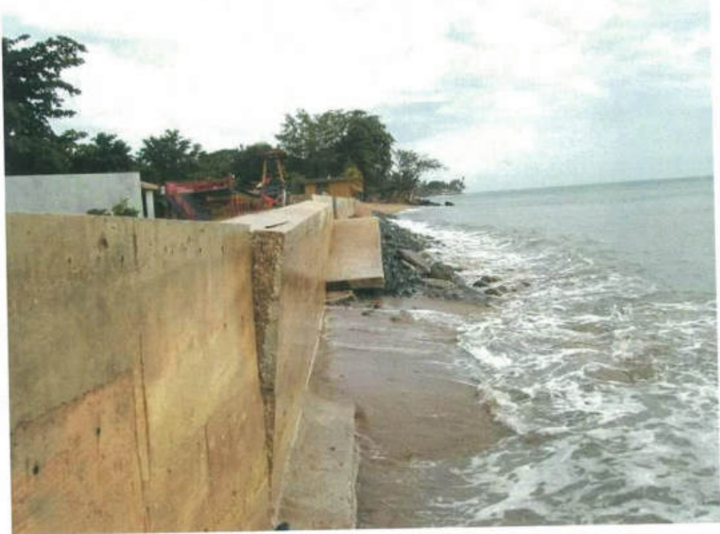
El muro que aparece en la foto (arriba) fue construido para detener la erosión en el balneario de Rincón, Puerto Rico y proteger la infraestructura allí edificada. Sin embargo, el muro ha colapsado.
