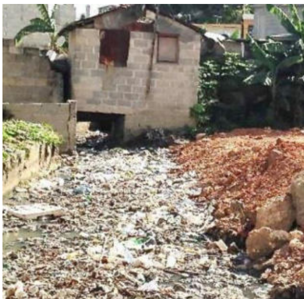
A. Los residuos sólidos obstruyen los canales de desagüe en Santo Domingo
