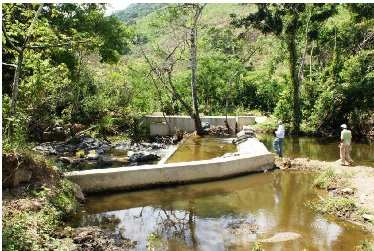
Acueducto INAPA en Reserva Forestal Cerro Chacuey
