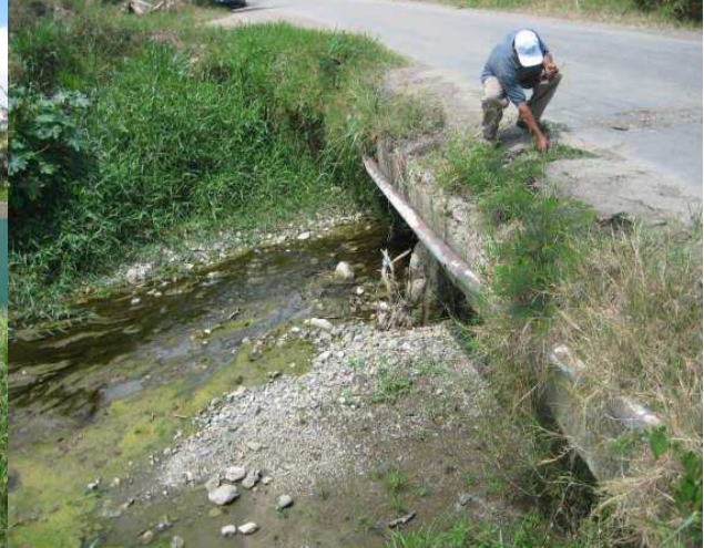
Vertimiento del matadero al Arroyo Guanábano
