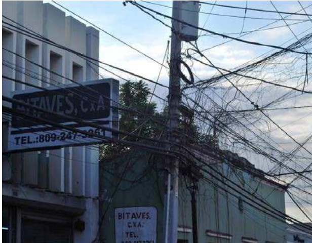
Vista del cableado en la Avenida Restauración
