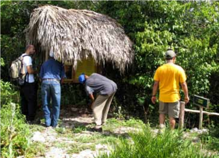
Foto 17. El techo del kiosco existente debe ser rediseñado para mejorar su visibilidad.
