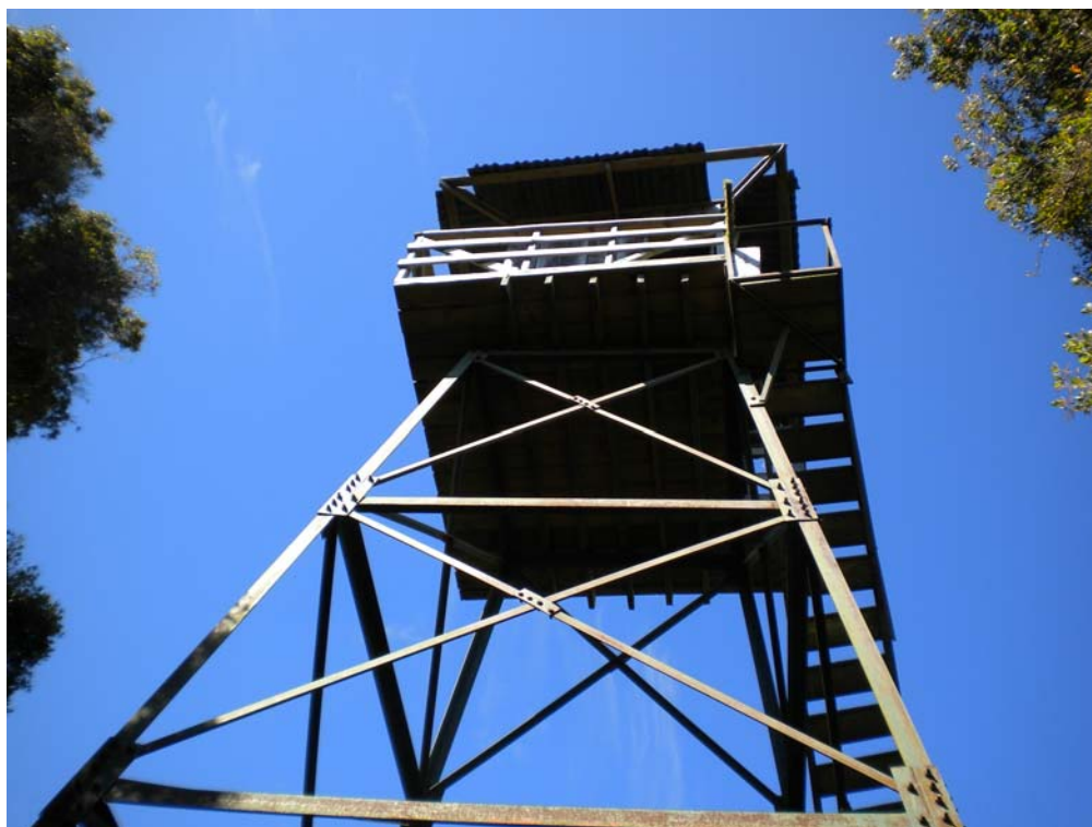
Foto No. 6 Vista de la caseta de la Torre de Pico del Gallo
