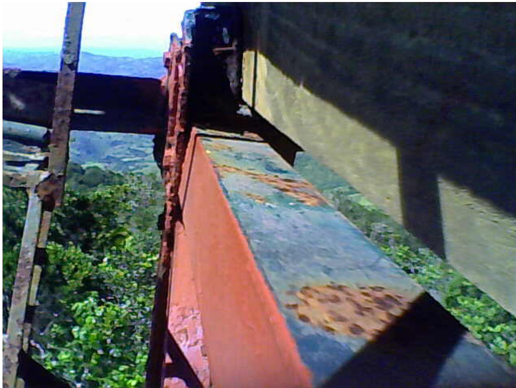
Foto No. 42. Vista de la parte metálica de la Torre en deterioro
