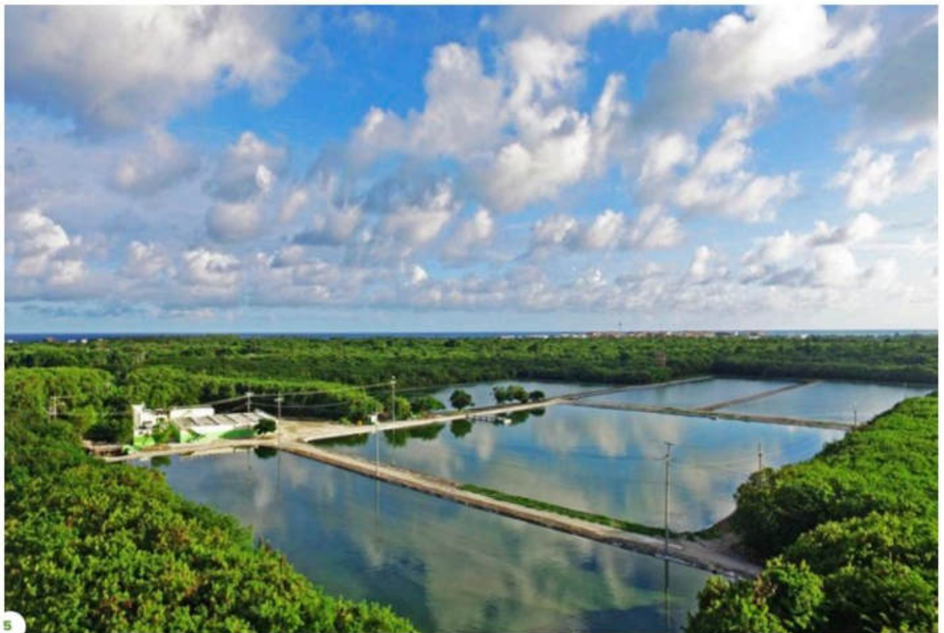
4-5. PLANTA DE AGUA RESIDUALES DE PUNTACANA RESORT & CLUB.
