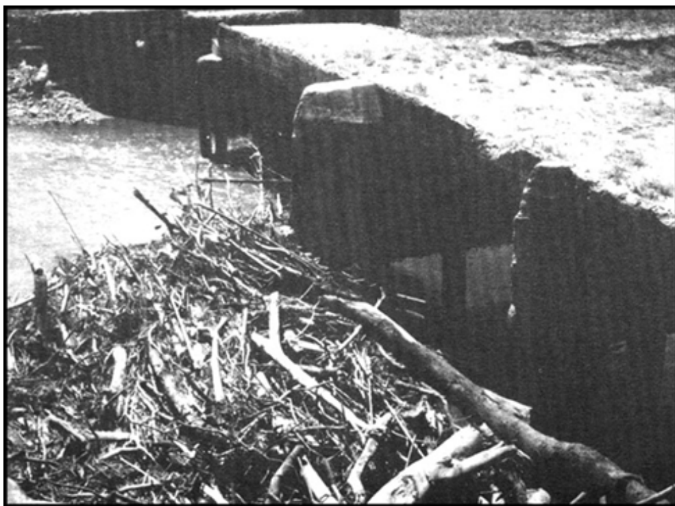
Foto No.6 Sobre el Río Yabó, destruido por Georges.
