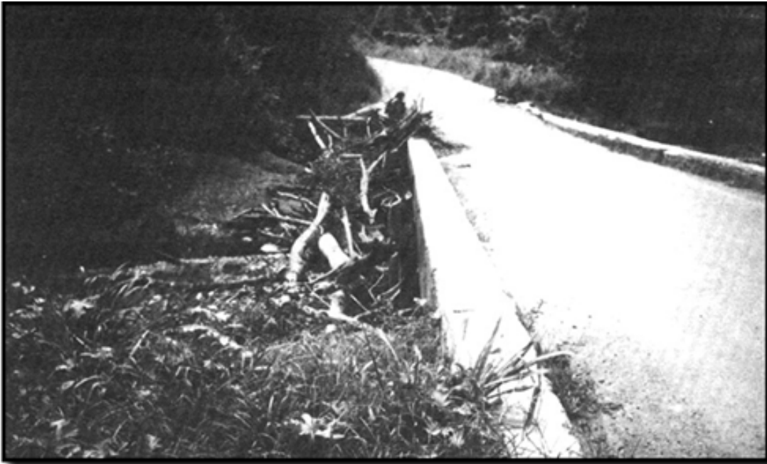
Foto No.7 Puente dañado. San Pedro de Macorís.
