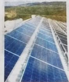
Paneles solares en SJM.
