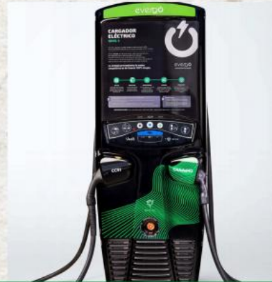
Instalarán 500 estaciones de carga para vehículos eléctricos en todo el país.
