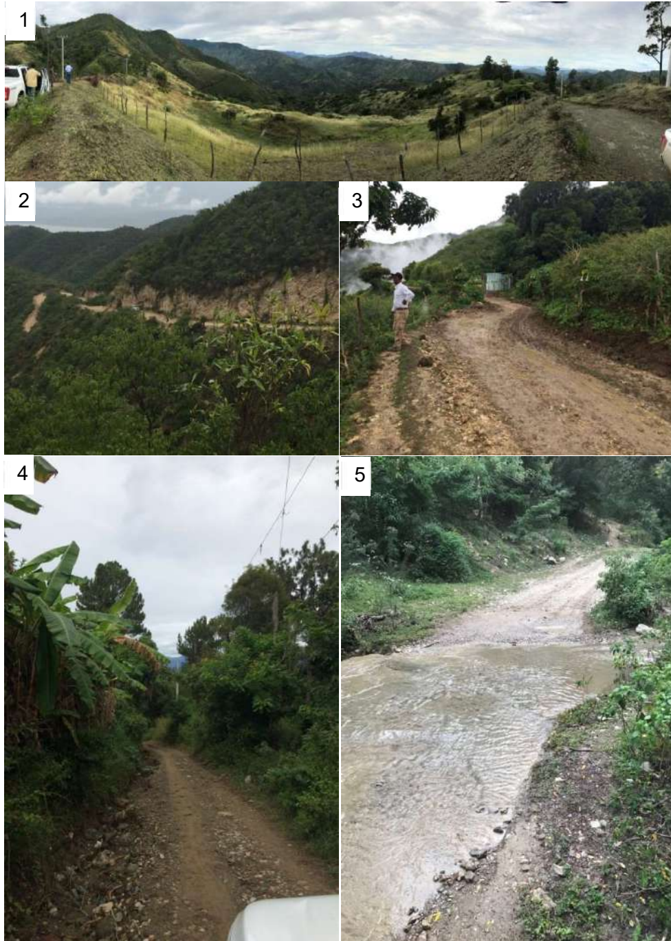
FIGURA 3-4 CONDICIONES TÍPICAS ENCONTRADAS EN LOS CAMINOS DE LA MUESTRA. 1. ÁREAS MONTAÑOSAS (SABANETA); 2 Y 3. TALUDES Y PEQUEÑOS DESLIZAMIENTOS (INDEPENDENCIA); 4. VEGETACIÓN COLONIZANDO LA SERVIDUMBRE; 5. DRENAJE TRANSVERSAL, SIN OBRAS.
