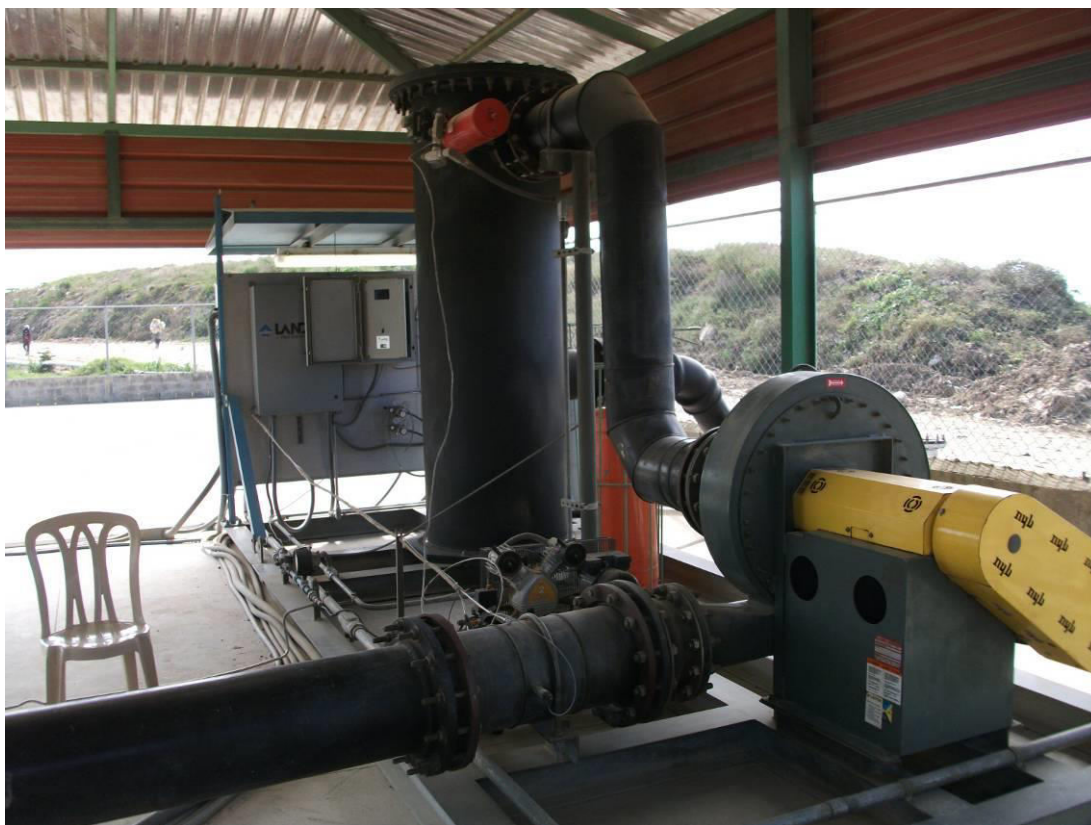
Ilustración 19. Equipo para la captación y quema de gases en el vertedero Duquesa en Santo Domingo en el año 2010 – la instalación ha sido destruida en el año 2013 por decisión política y intereses económicos.
