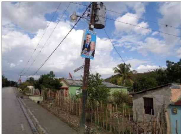
Foto 2.1-4. Tendido eléctrico en la Sección Abras Las Yayas del distrito municipal El Rosario.
