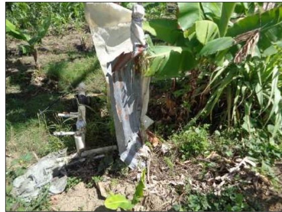
Foto 2.4.2-5. Tubería utilizada para riego por goteo en Vallejuelo.
