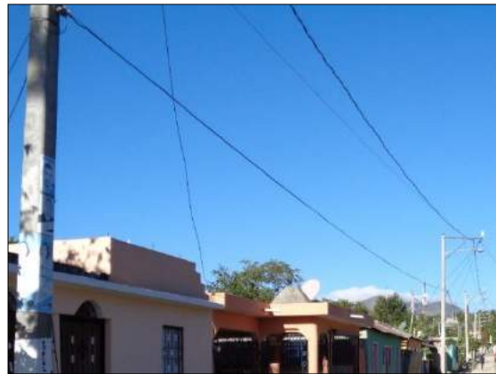
Tendido eléctrico en el Barrio Los Pinos.
