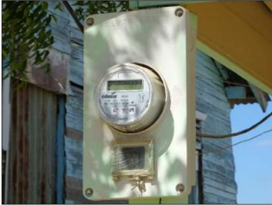
Contador eléctrico en la zona urbana.
