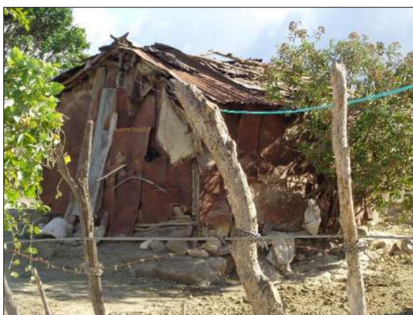
Fotos 3.1-3 Viviendas en mal estado en su estructura en el municipio de Vallejuelo, tomadas en enero 2016.
