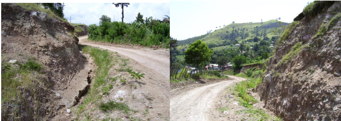
Construcción de caminos vecinales sin protección de taludes en Las Lagunas
