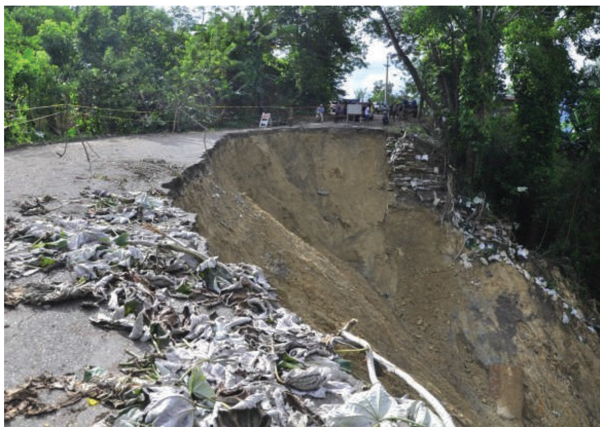
Figura 224.2 Deslizamiento de tierra, Puerto Plata.
