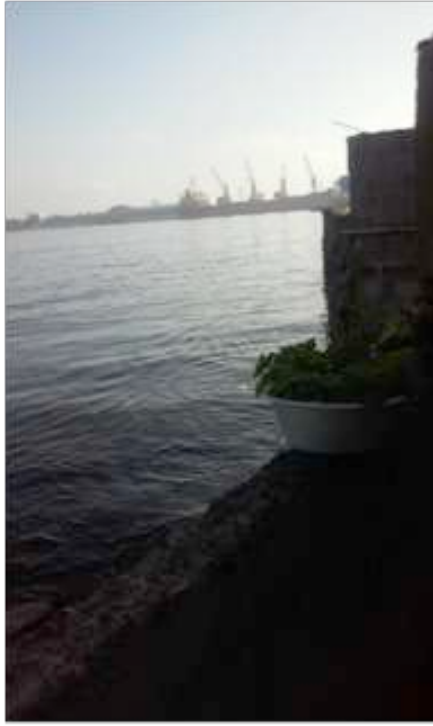
Muro de contención, realizado con el presupuesto participativo. Sólo un 20% realizado.
