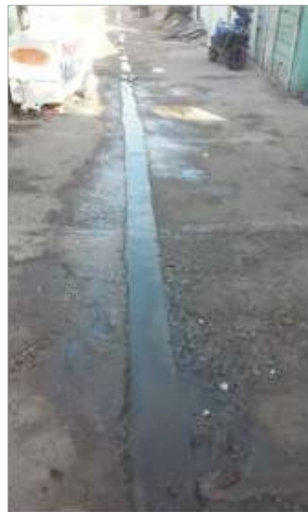
Vista de las aguas residuales en los principales pasillos internos del barrio
