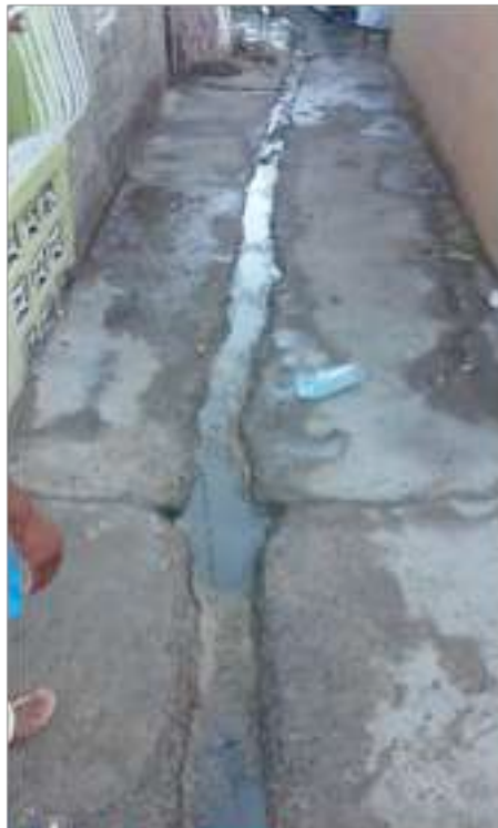
Vista de las aguas residuales en los principales pasillos internos del barrio
