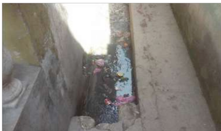
Vista Este, Final de Calle Principal, colinda con la pared del cementerio el Tamarindo. Aguas residuales y desperdicios sólidos en la principal conexión al canal de desagüe principal que atraviesa Barrio Blanco 1 y Canta La Rana hacia el río Higuamo.
