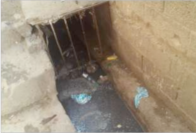
Vista Este, Aguas residuales y desperdicios sólidos en la rejilla principal conexión al canal de desagüe principal que atraviesa Barrio Blanco 1 y Canta La Rana hacia el río Higuamo.
