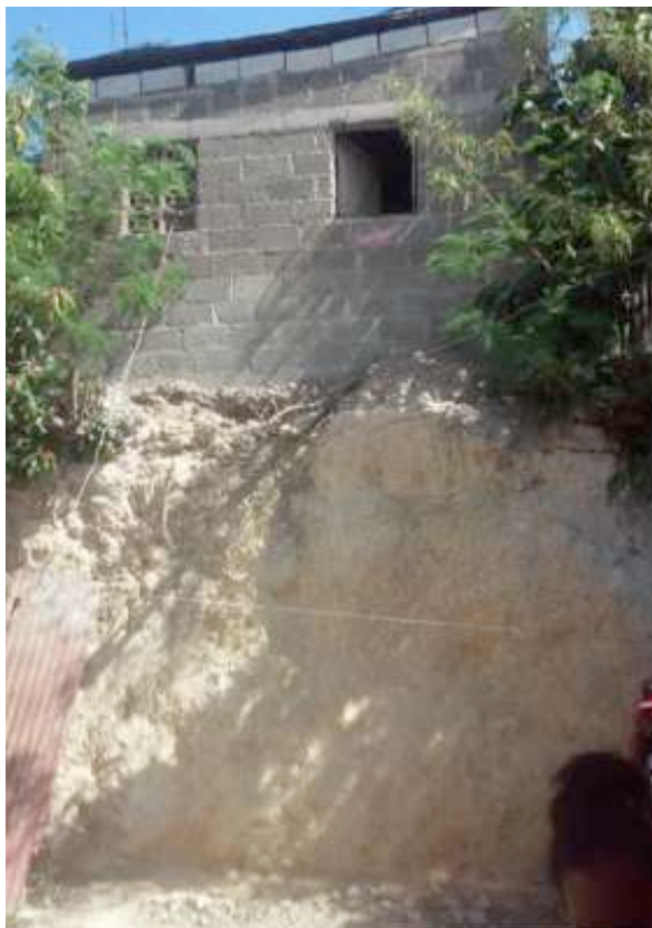
Área de deslizamiento y derrumbes, provocado por lluvias. Poniendo en peligro vidas y propiedades
