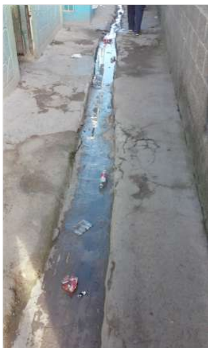
Parte en donde el ayuntamiento puso cemento dejando por fuera el canal desagüe
