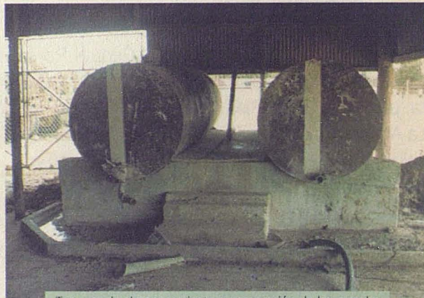
Tanques de almacenamiento y preparación de las mezclas
