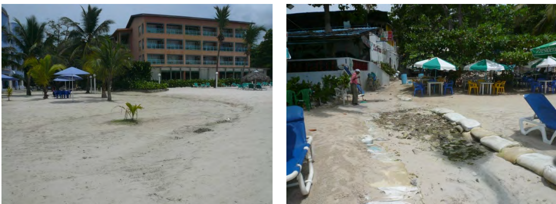
Figura 28: Pluviales en la playa de Boca Chica Tradicional, se puede apreciar agua estancada en la fotografía de la derecha.
